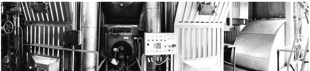
Nízkoemisný plynový horák kotla K1 po denitrifikácii
